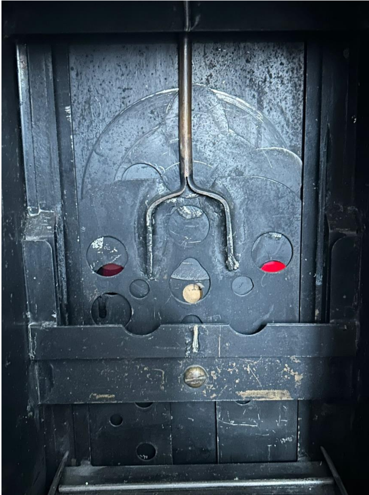
Abb. 6 Williams Signallaterne, Innenansicht nach Entfernung der Leuchtmittel.
